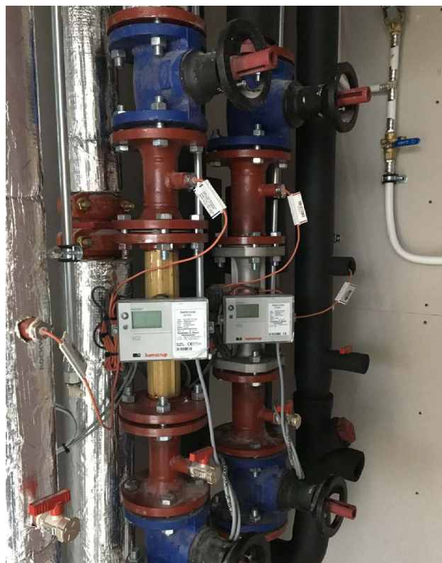
Illustratie: Submeters in leidingsschacht
