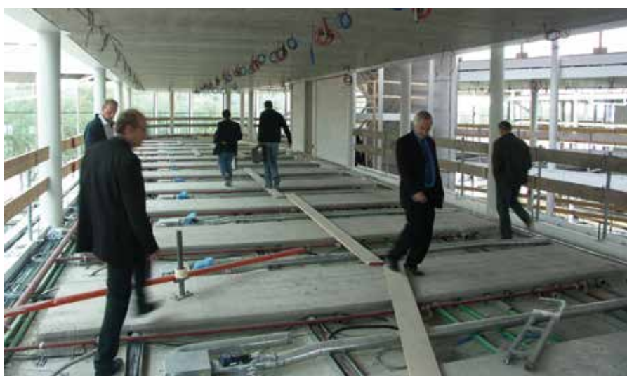
■ Vloeropbouw Gebouw Rijkswaterstaat Westraven met betonkernactivering en ventilatie-units.
